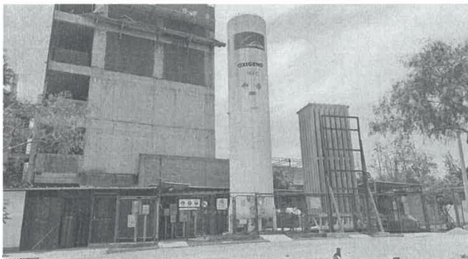
Central de Distribución de Oxígeno Líquido. Fuente: Dpto. de Farmacia
